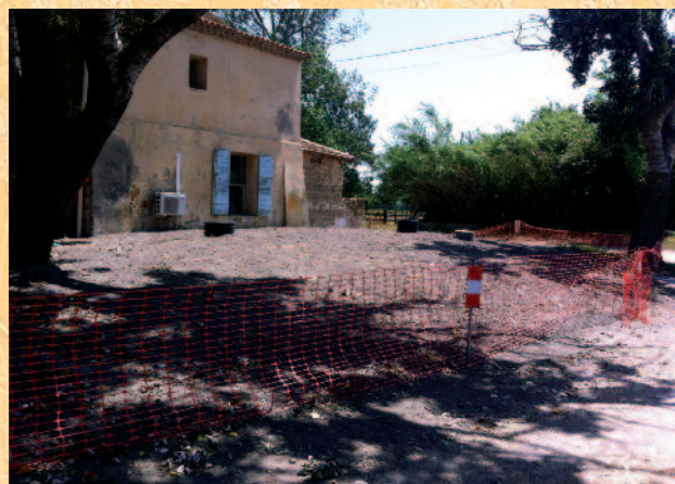
Le nouveau système, entièrement enterré, permettra d'être aux normes pour l'occupation du mas et de la bergerie.
