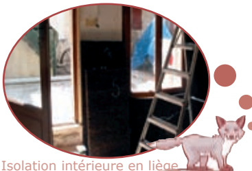
Isolation intérieure en liège
