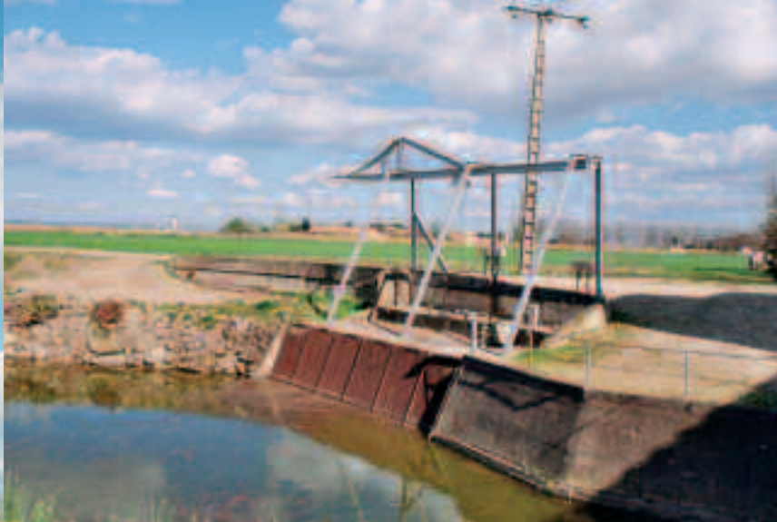
Dégrillage de la station d'Albaron : arrivée des eaux du canal du Rousty.
