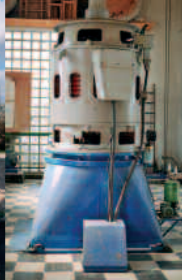
Une des pompes de la station d'Albaron.
