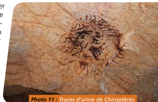
Photo 11 : Traces d'urine de Chiroptères au plafond d'une cavité.
