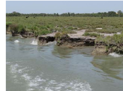
Erosion des berges
