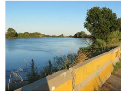
Instabilité des berges
