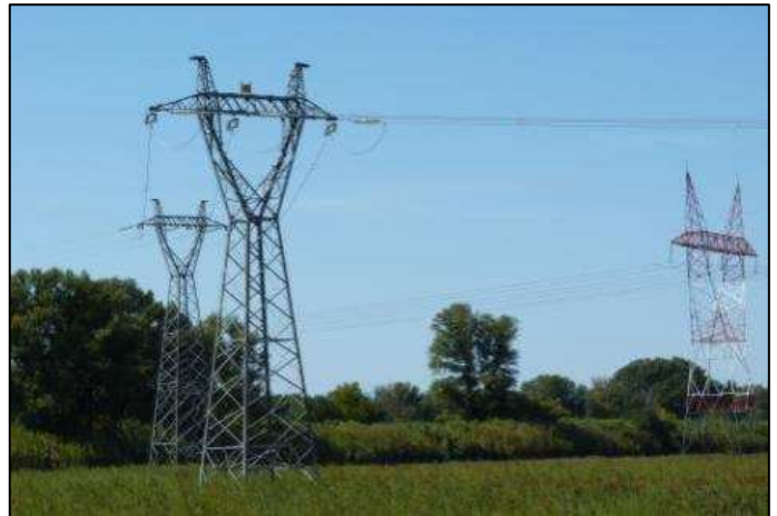
Figure 43 : Réseau dense de lignes électriques sur le site
